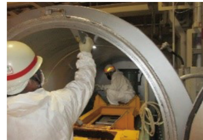
機器内部汚染検査
